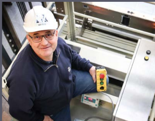
Franz Josef Karner ist schon seit 42 Jahren im Betrieb und kennt alle Aufzugssysteme bis ins Detail.
